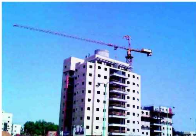
לשם הצלחת הפרויקט, חשוב להיוועץ באנשי מקצוע מתחום המשפט והמס. בניין בהקמה ■ צילום: הרצל יוסף
